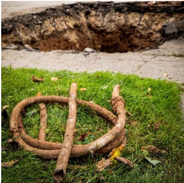
Tuberías de plomo
